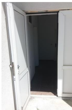
Slika br. 7. Oštećena vrata
